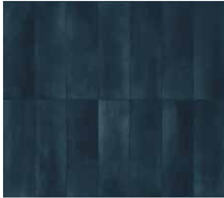
Fuga tono su tono. Tone-on-tone grout.
